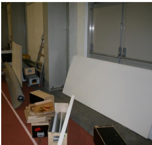
Mynd 1. Dæmi um hvernig á ekki að ganga um flóttaleið. Flóttaleið skal vera hindrunarlaus, einnig þegar unnið er við framkvæmdir
