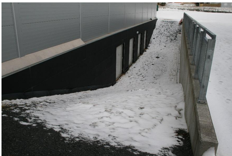
Mynd 4. Dæmi um flóttaleið í halla þar sem flóttahurðir opnast út og þrengja leiðina og snjórtakmarkar virkni hennar.
